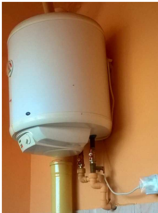
fot. 9: Elektryczny podgrzewacz wody
