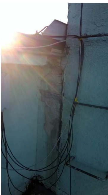
fot. 3: Fragment uszkodzonej elewacji
