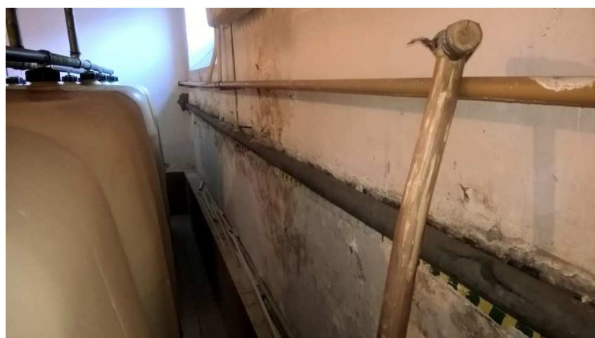
fot. 4: Zawilgocenie ściany w piwnicy
