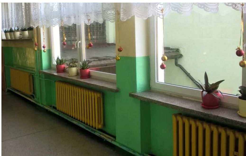
fot. 8: Grzejniki, instalacja c.o. - piony i poziomy
