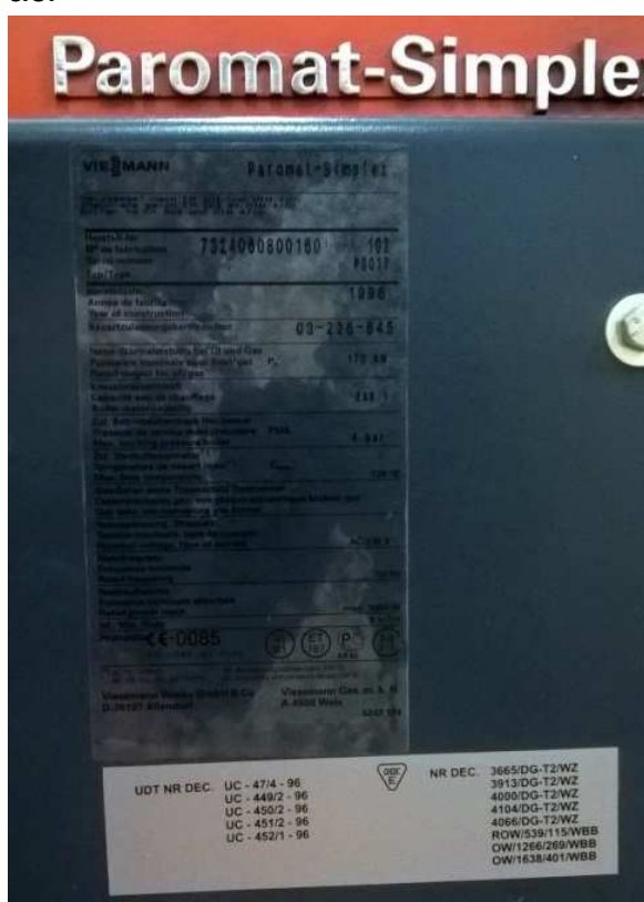
fot. 7: Tabliczka znamionowa istniejącego kotła olejowego
